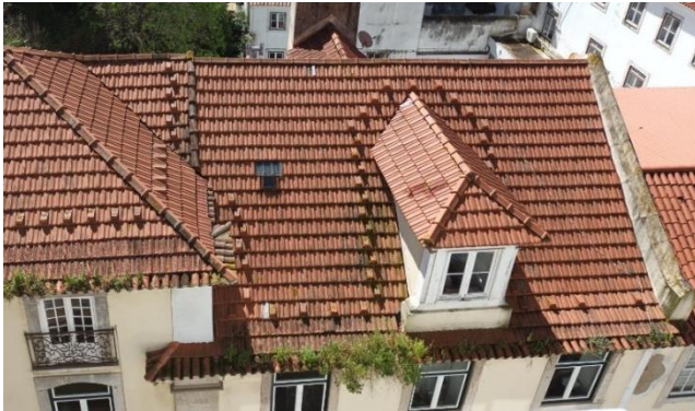
Imagen 1 y 2. Acabados discontinuos de tejados. Fte: autora Mar Barbero
